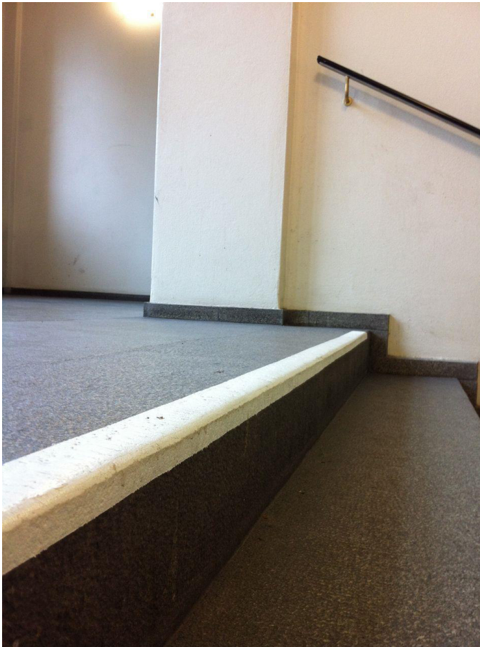
Treppe im Hauptgebäude mit zu kurz geführtem Handlauf
